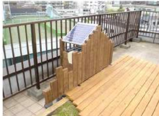
雨水タンクとソーラーパネル
